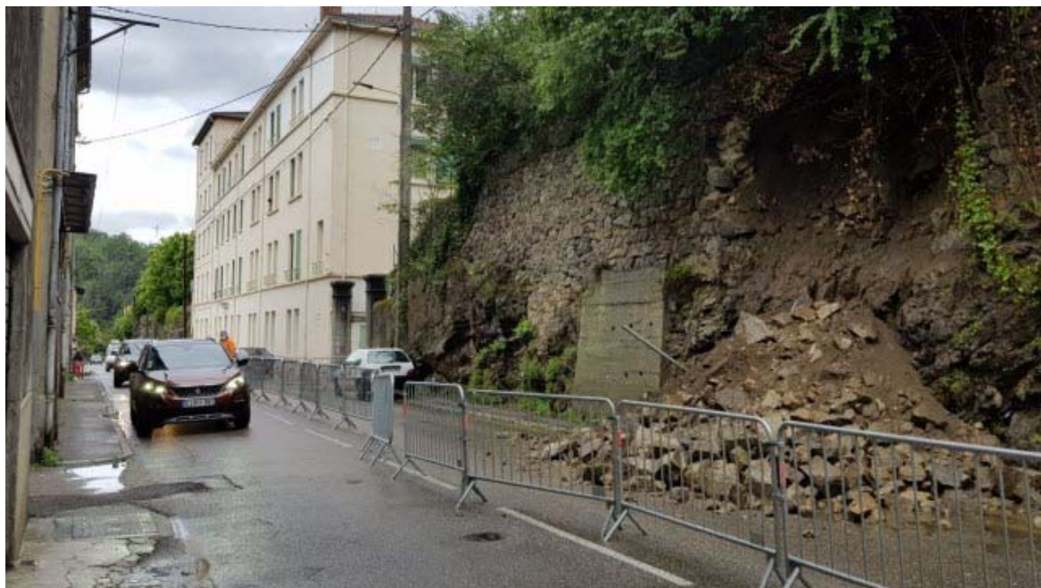
Un mur de soutènement s'est effondré à Annonay. Photo Le DL/ Etienne GENTIL
